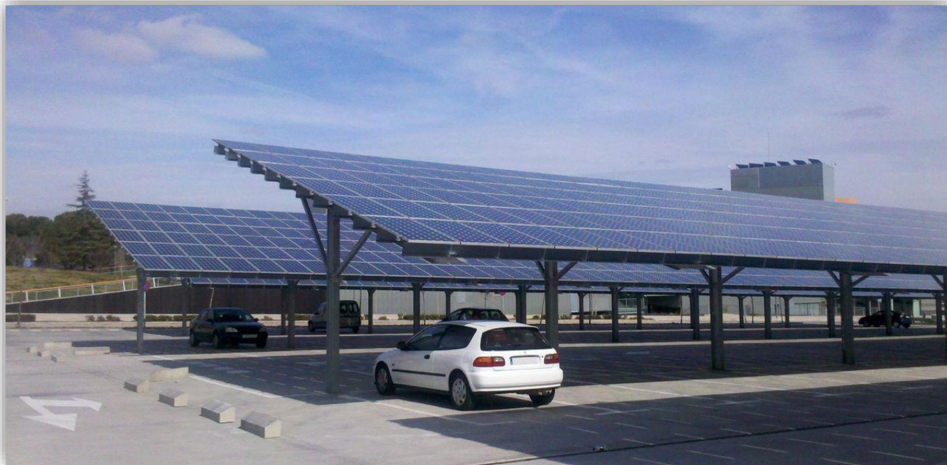
En parkering med solcellstak.
