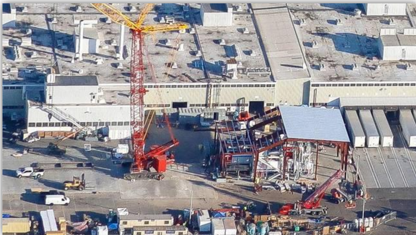
Teslas gjutpress som installeras utanför fabriken i Fremont.
